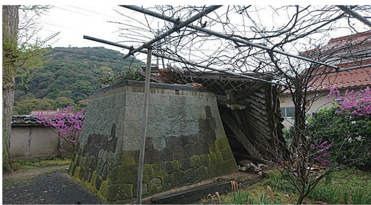
全壊した鐘楼 (大田東組 立善寺)
